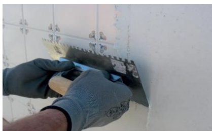
Barramento sobre cerâmicos antigos
